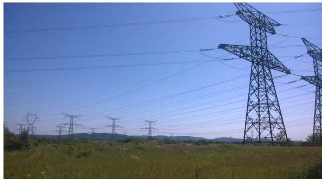
Terrains au droit du poste interconnexion très haute tension
